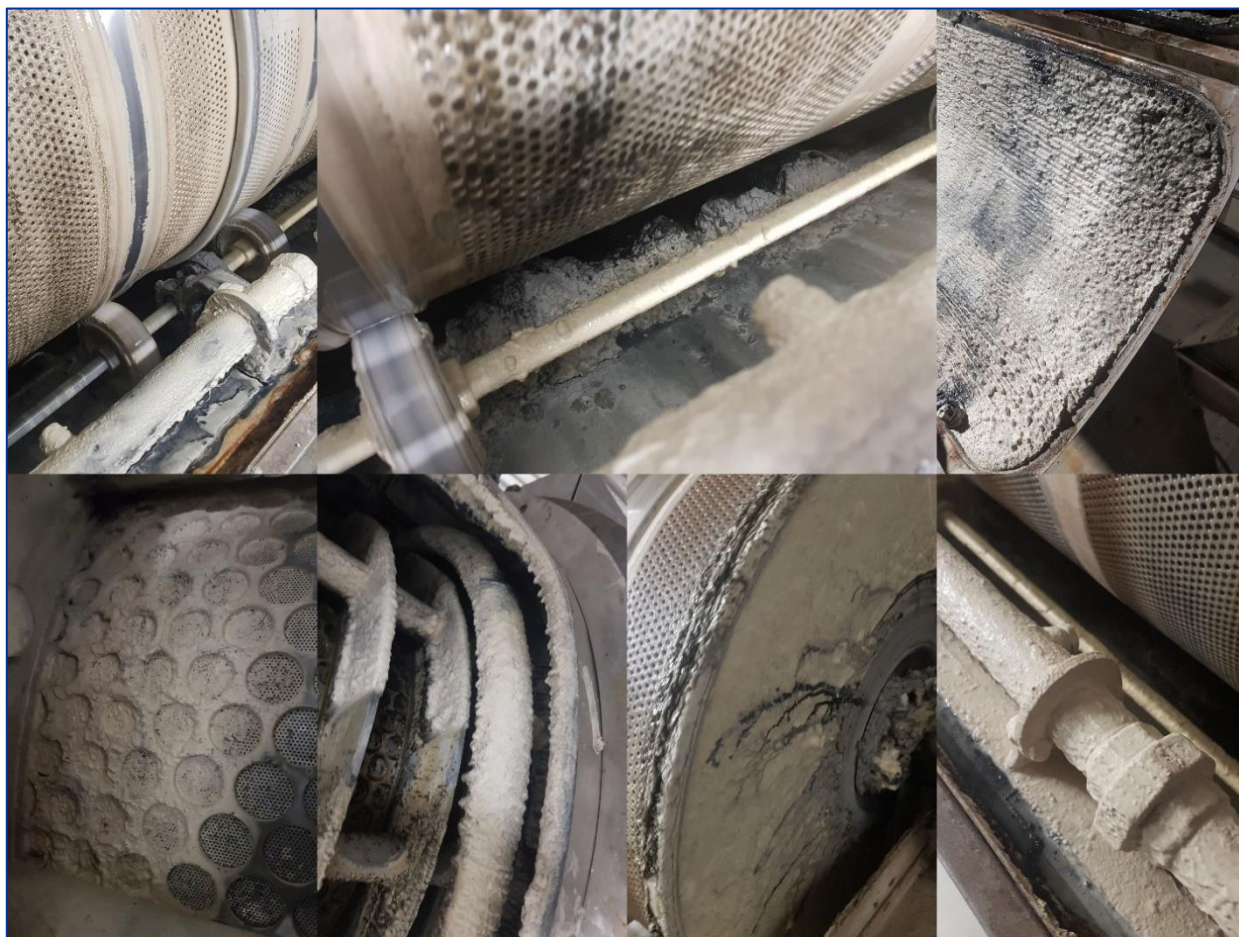
Figuur 3: Impressie van de witte aanslag op verschillende onderdelen van de installatie, waaronder de DFP-unit en trommelfilter.
