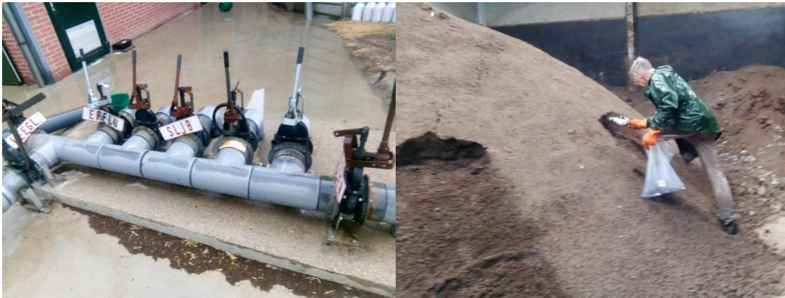
Figuur 3 Links: aansluitingen voor effluent, slib en ingaande drijfmest. Vier varkenshouders delen de installatie en leveren varkensdrijfmest aan. Rechts: staalname dikke fractie bij V2.
