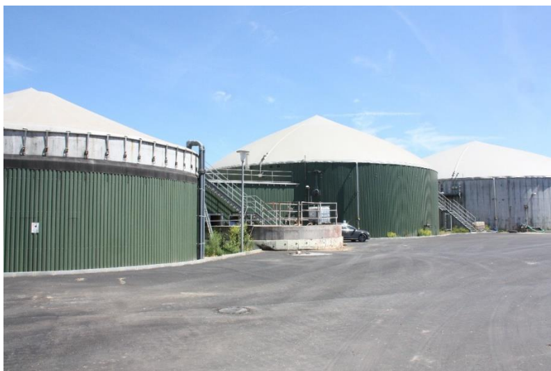
Figuur 4: Biogasinstallatie op het bedrijf van Van der Tillaart.
